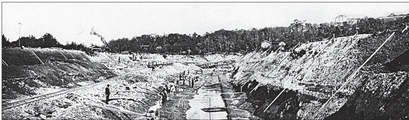
■ Obr. 4 Příklad nepřírozené změny povrchu říčního údolí – kanalizace Labe na počátku 20. století.
