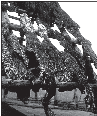
Obr. 5 Polorozpadnutá krytina z kôry – dôsledok chýbajúcej údržby. ■ Decaying bark covering - result of a lack of maintenance. ■ Halbzerfallene Borkenbedachung – Folge der fehlenden Wartung. ■
