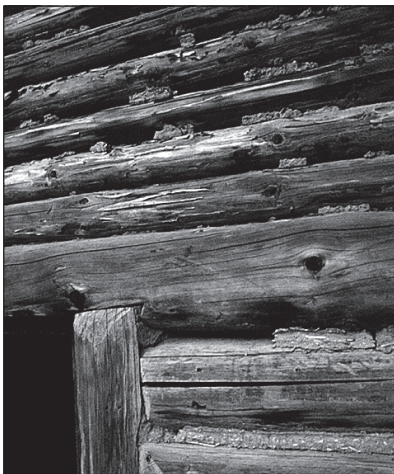
Obr. 4 Popraskané a vypadané hlinené škárovanie – chýbajúca údržba. ■ Cracked and fallen clay pointing - lack of maintenance. ■ Geborstene und ausgefallene Fugen-Lehmausfüllung – fehlende Wartung. ■
