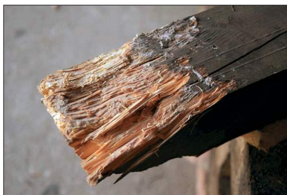
■ Obr. 6 Poškozený konec páky.
